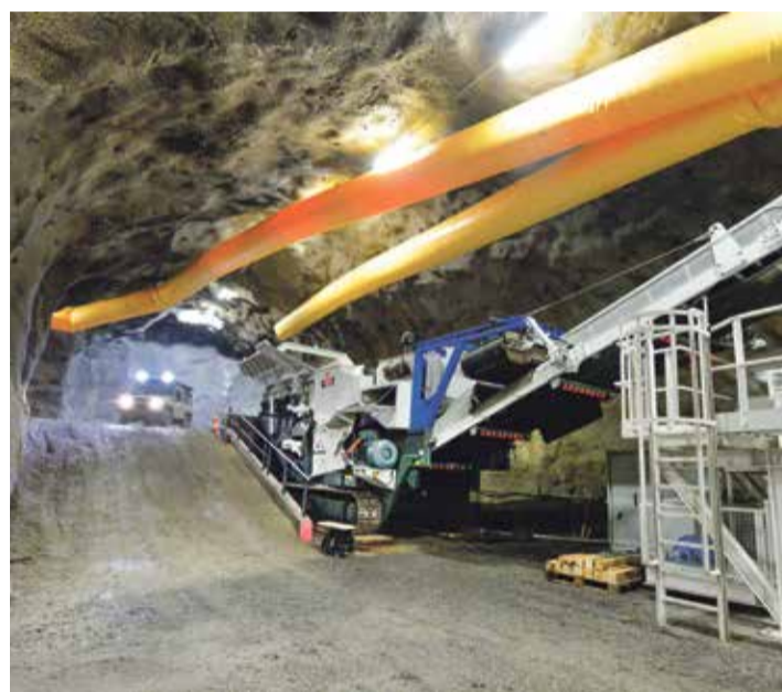
Depuis 2018 déjà, l'entreprise travaille en souterrain avec notamment le tunnel d'accès et le puits de dévalage. | Archives-24heures
