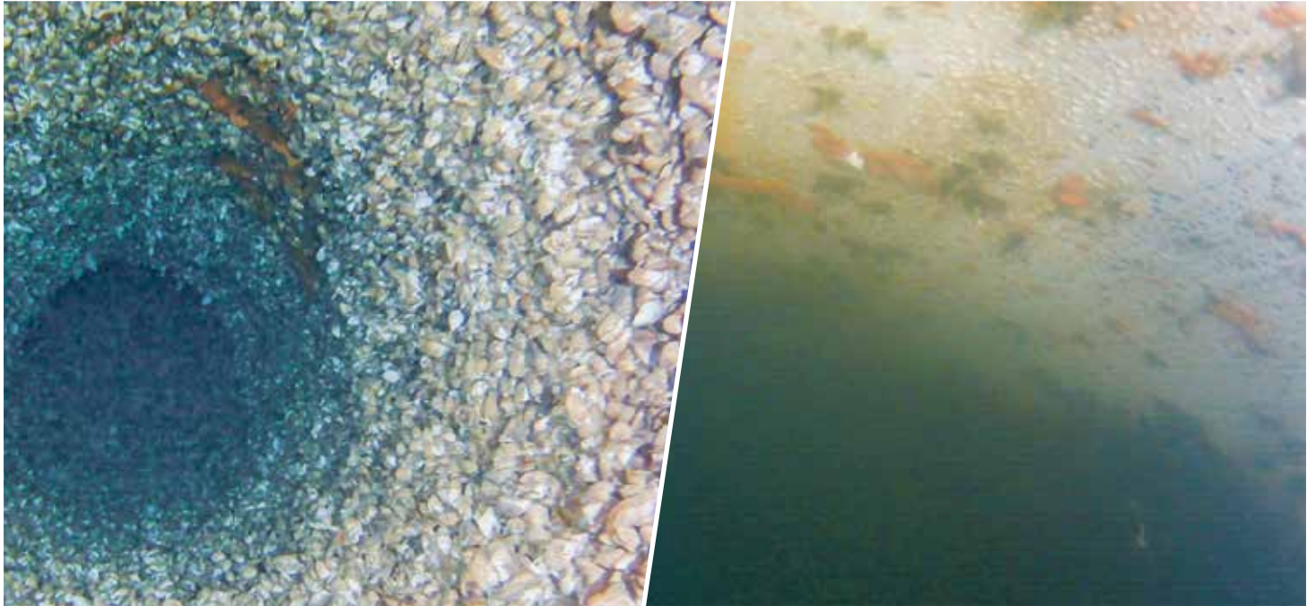
Avant l'opération (photo de gauche), les moules quaggas avaient colonisé l'intérieur de la prise d'eau sur une épaisseur de 3 cm. | SIGE
